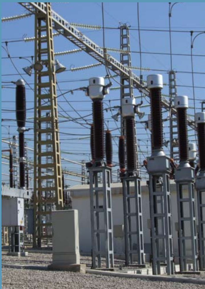
Una de les noves subestacions estarà al costat de les instal·lacions de Viladecans
